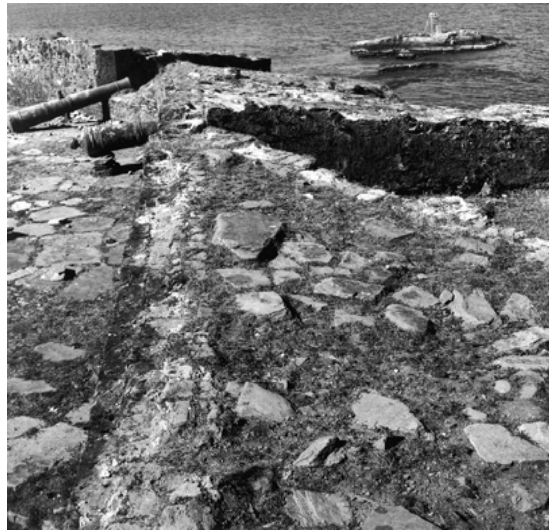
c.1968. Cubierta de merlón destruida
