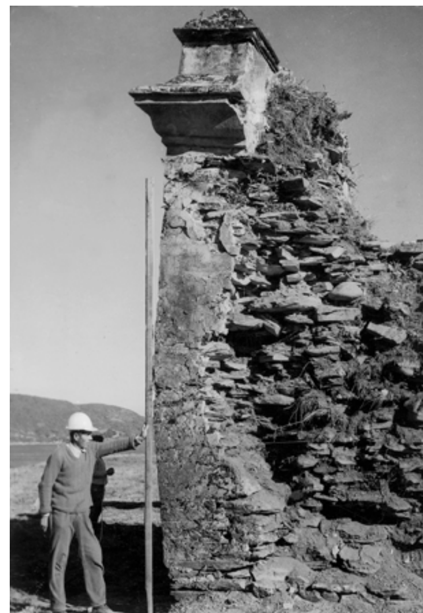
c.1972. Deformación muro lateral y fachada de la iglesia
